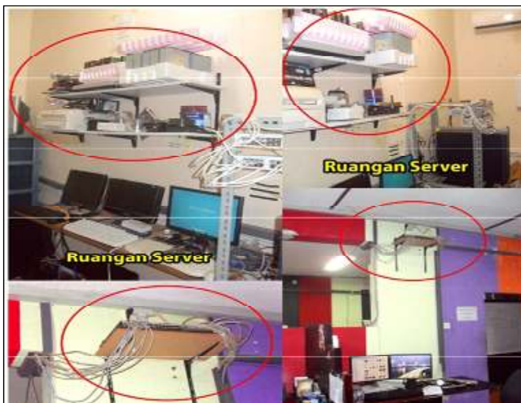
Gambar 3.2 Permasalahan fisik penempatan perangkat pada ruangan server
